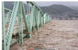
熊野大橋にまで押し寄せる洪水
